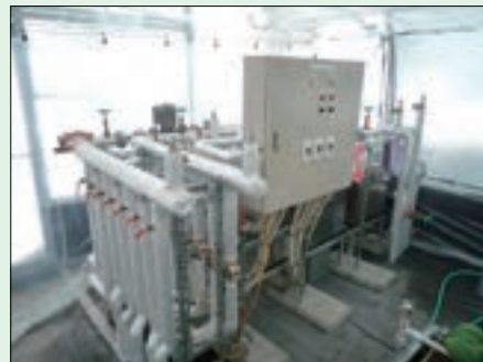
ニセコ高校エアハウス地中熱ヒートポンプ設備
