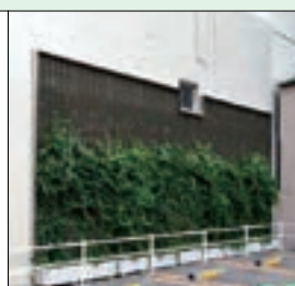
既成市街地に設置した緑化壁
